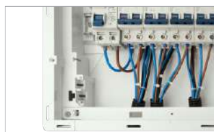
Amplio espacio para el cableado
